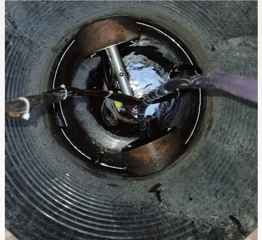
Flödesstyrd mätning, insats för flödesmätning monterad i ledningens inlopp ses i övre del av bild
